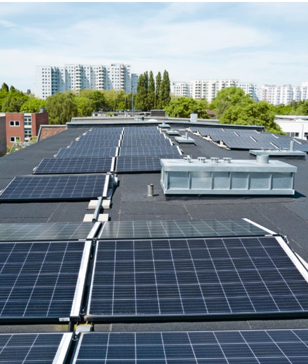
Solarpaneele auf dem Dach der Wohnanlage Sorthmannweg/Stresemannallee: Die Anlage ist für die Stromversorgung von bis zu 32 Wohnungen ausgelegt.
