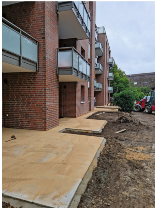
Wohnanlage Langenhorner Chaussee: Im Zuge der energetischen Modernisierung wurden auch die Balkone und Terrassen erneuert.
