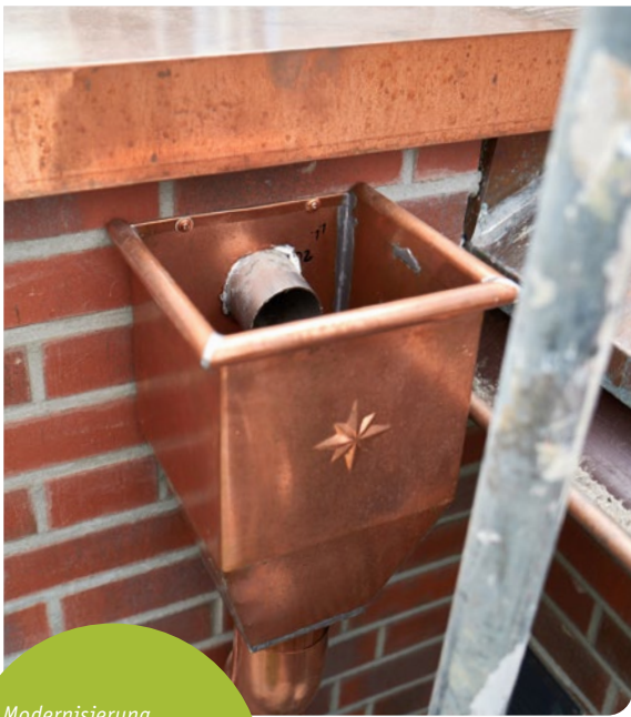
Modernisierung Langenhorner Chaussee: Auch das Dach und die Gauben wurden umfassend saniert.
